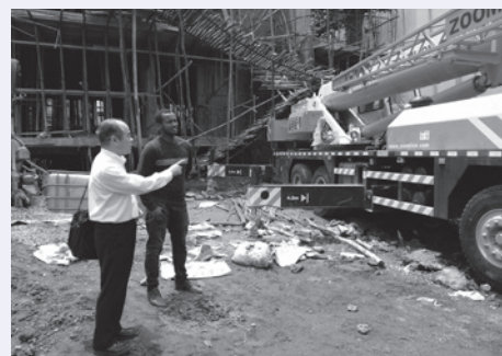
エチオピア地熱発電事業協力準備調査で 既存大型クレーンの状態を確認
