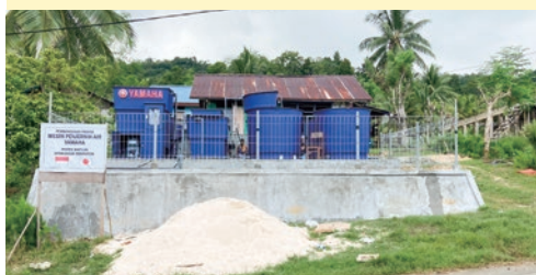
村落に整備された浄水装置(提供:ヤマハ発動機(株))
