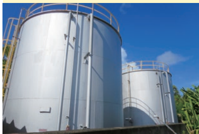
ツバル電力公社の燃油タンク
