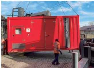
自治体・公共設備：発電機のドニプロ市到着
