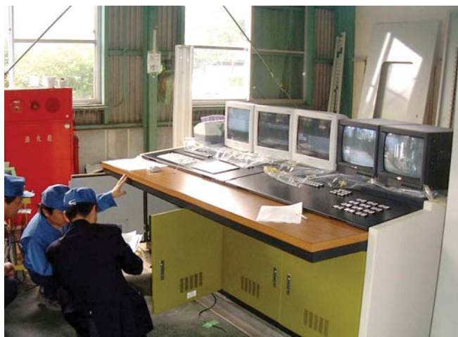
供与機材本邦調達支援サービス—炭坑内集中監視システムの納入前検査を行うJICS職員
